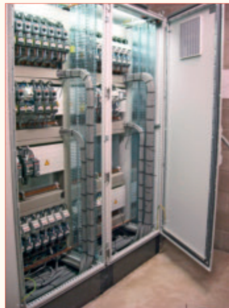
Koster E&I heeft bij de Lentse Potgrond alles op elektrotechnisch en softwarematig gebied ontwikkeld en uitgevoerd, van de verlichting, de paneelbouw en ontwikkeling van alle PLC-programma's tot de visualisatie en rapportage van de gehele productie.
